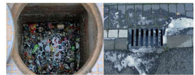
Afbeelding 6. Hemelwaterput bij marktterrein (links) en lozingen op regenwaterriool (rechts)
